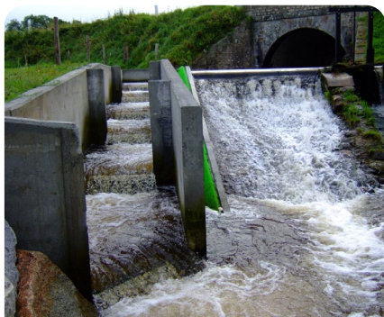
Passage à poissons du Bieu
